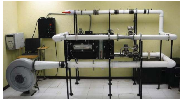
Fig. 3. Instalación didáctica para instrumentación y control de procesos.
