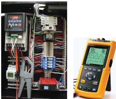
Fig. 4. Analizador de energía conectado en la salida del variador de frecuencia.
